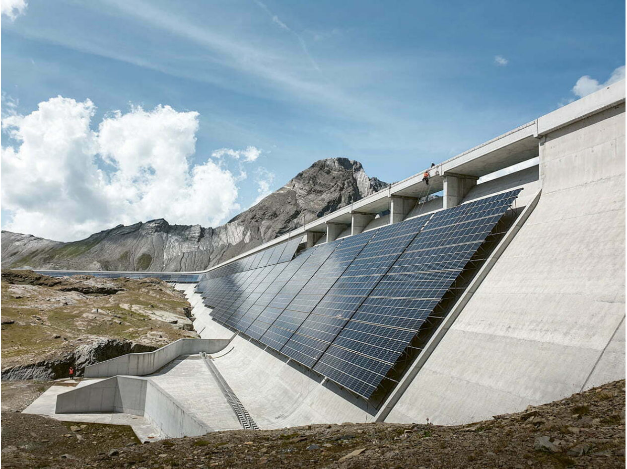
Die grösste alpine Solaranlage der Schweiz an der Muttschsee-Staumauer auf 2500 Metern.
