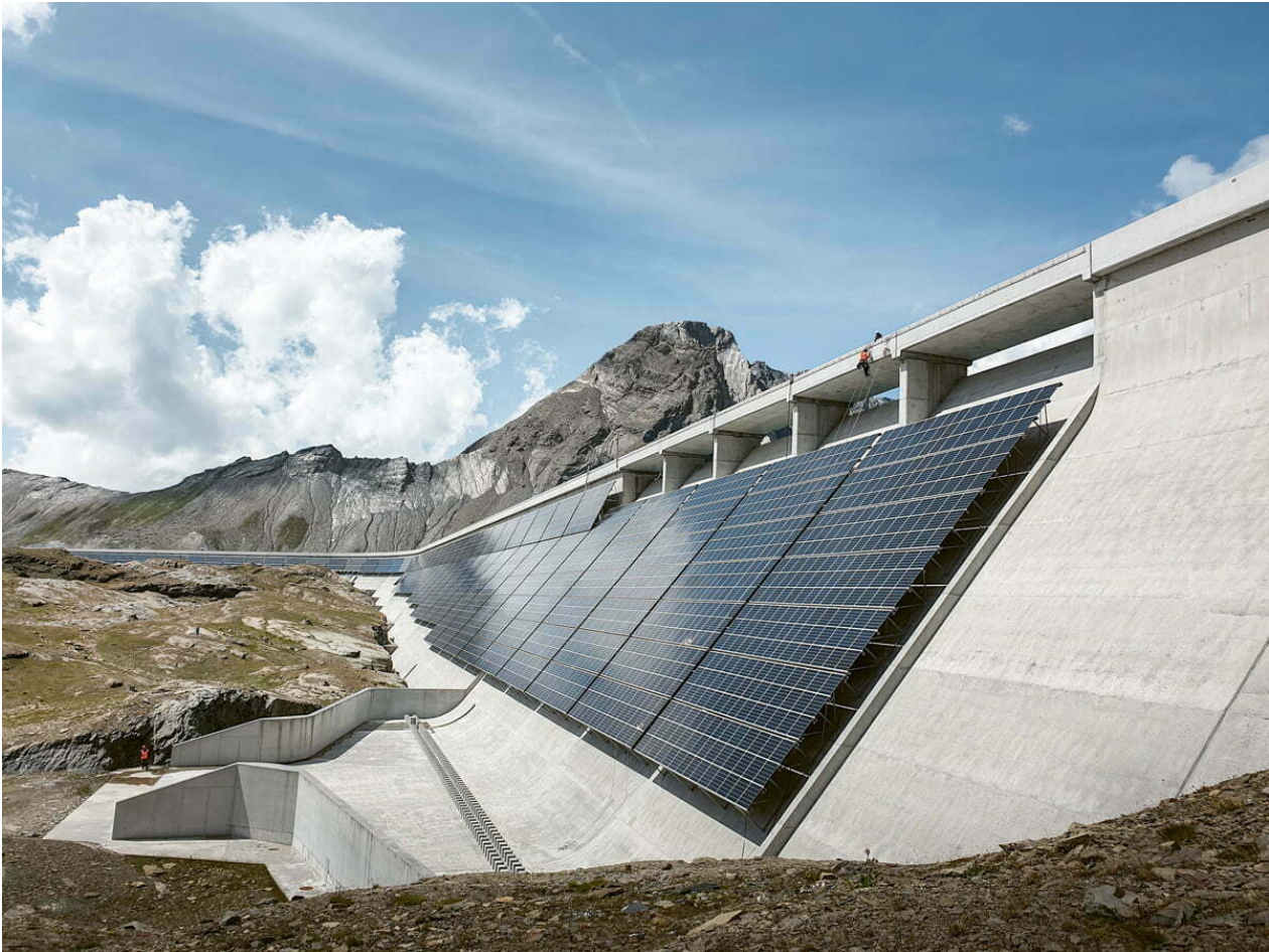
Die grösste alpine Solaranlage der Schweiz an der Muttssee-Staumauer auf 2500 Metern.
